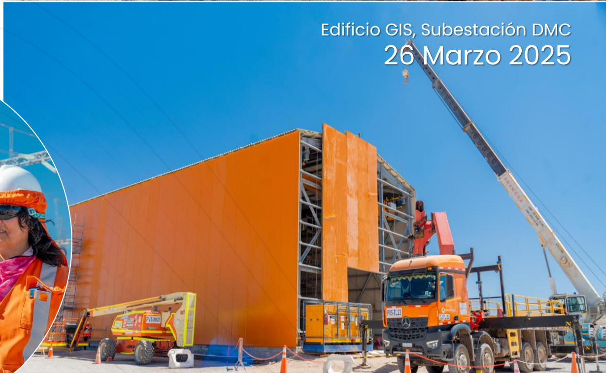
Subestación Nueva Centinela 26 Marzo 2025
